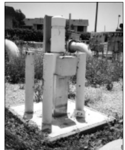
El pozo MW-SF-4, un pozo de extracción de vapor ubicado en el área sur, cerca de la válvula de bloqueo intermedia, se utilizó para el monitoreo del agua subterránea tras la detección de la fuga.
